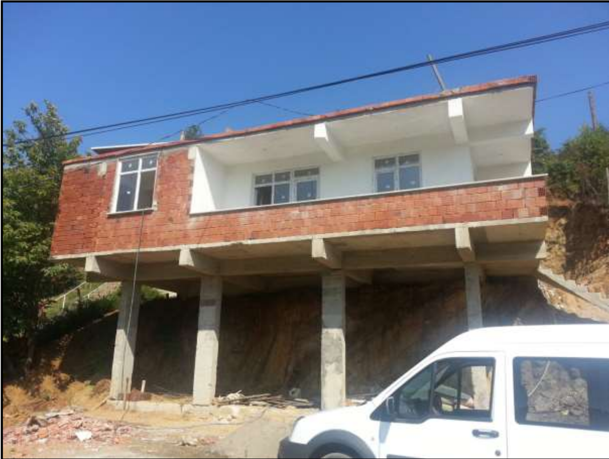
CİDE İLÇESİ ÇAYYAKA KÖYÜNDE YAPILAN İZİNSİZ İNŞAAT
